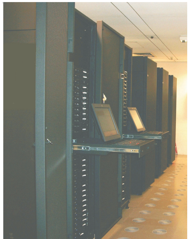
Rack-Server-System des Rechenzentrums
