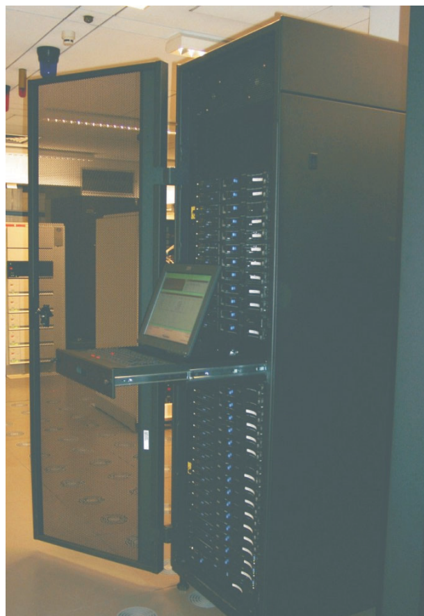
Firewallsystem-Rack für die Universität Karlsruhe im „Sicherheitstrakt“ des Rechenzentrums ...
