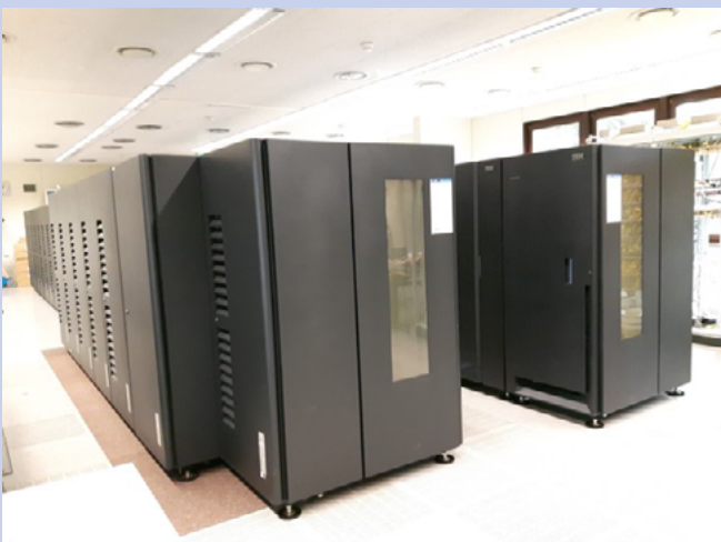
Bild 2: TS3500 Bandbibliothek Gebäude 141, Campus Nord
