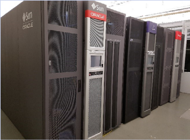
Bild 1: SL8500 Bandbibliothek Gebäude 441, Campus Nord
