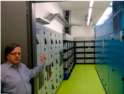
Bild 4: Einblick in die Batterieschränke der USV-Anlage.
