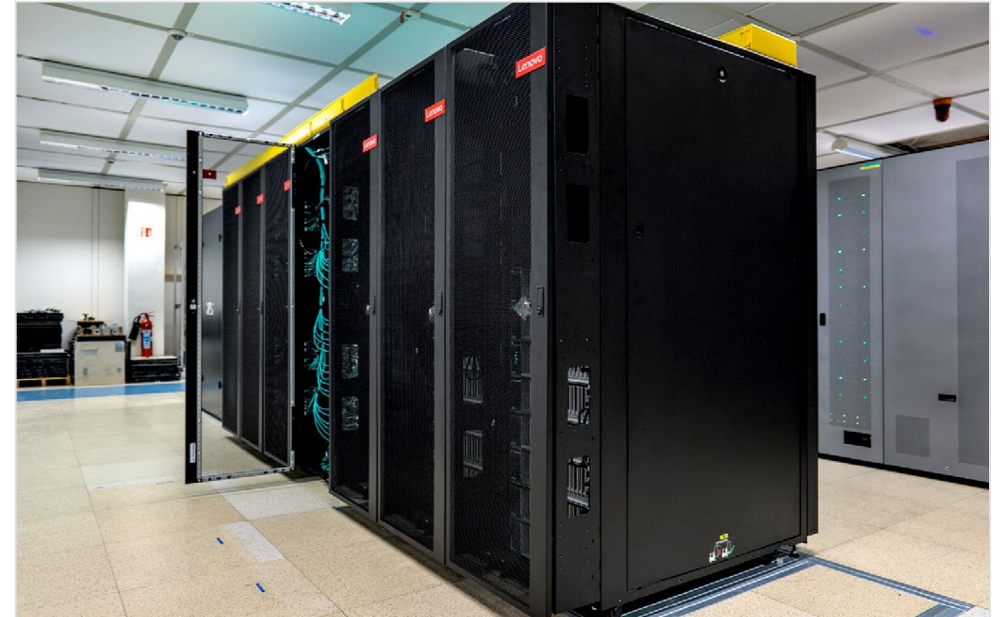
Abbildung 1: Die Hardware der im November 2022 neu in Betrieb gegangenen bwUniCluster 2.0 Stufe 2 in den Rechnerräumen des SCC
